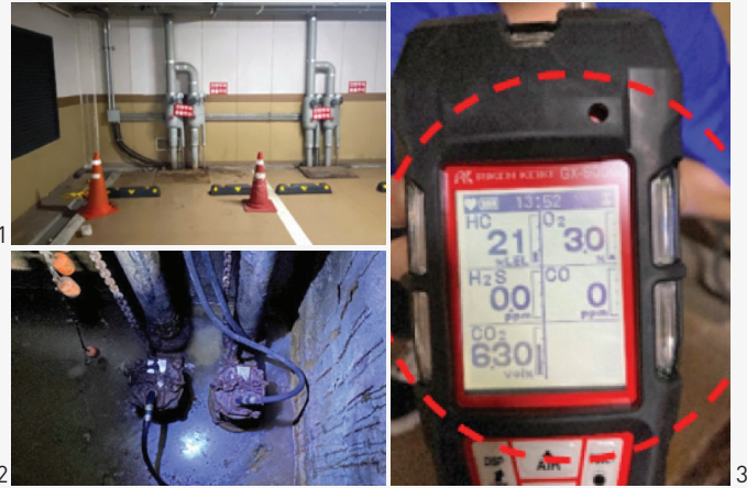
1 사고 현장 전경 2 사고 현장 내부 3 사고 현장 공기 농도
